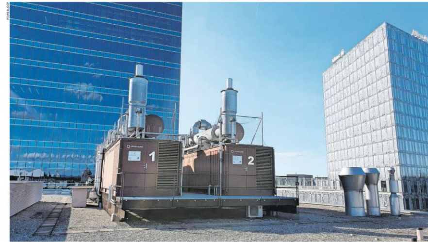
2 x 1 MW el sur un toit à ZH (ici une génératrice de secours, photo Powerloop.ch )
